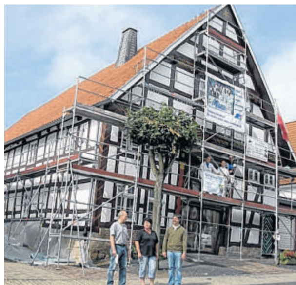
Mit einer solch alten Bausubstanz zu arbeiten ist eine echte Herausforderung für die Restauratoren. Foto: ad
