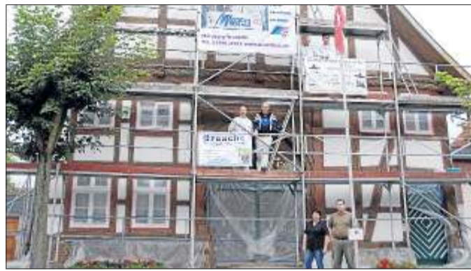
Sobald die letzten Arbeiten erledigt sind, erstrahlt das denkmalgeschützte Haus Böttcher in neuem Glanz.
